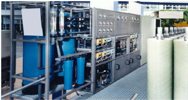
Ters Osmoz Arıtma Ünitesi
